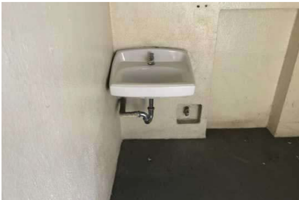
47 MISSING ADA SINK PIPE WRAP
